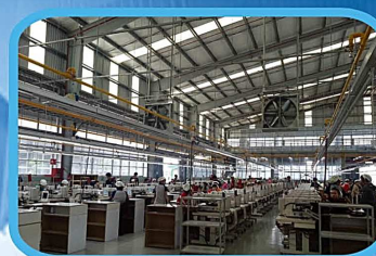
廠房內配電系統
